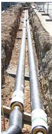
Tubature per teleriscaldamento.
