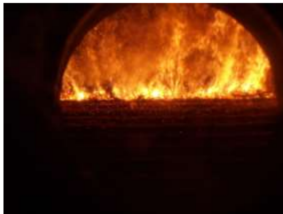
Il forno della centrale di teleriscaldamento di Dobbiaco.
