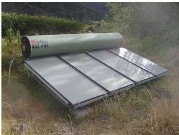
Pannello solare termico
