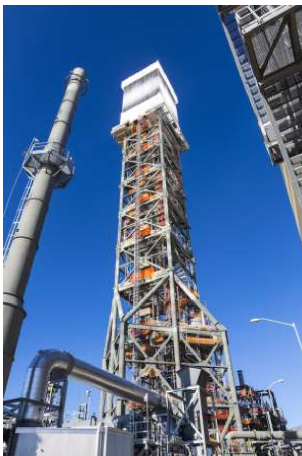
Foto di una delle tre torri a concentrazione solare
