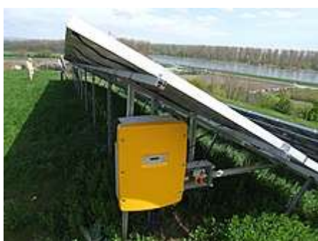
Un inverter per un impianto solare autoportante installato a Spira, in Germania
