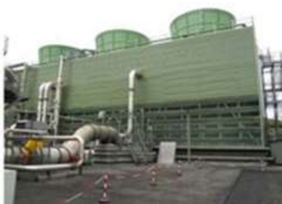
Torre di raffreddamento a tiraggio indotto.
