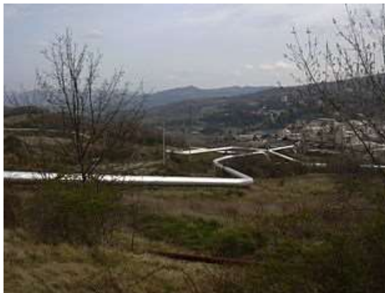
Le condutture che convogliano i vapori, proveniente dai pozzi geotermali
